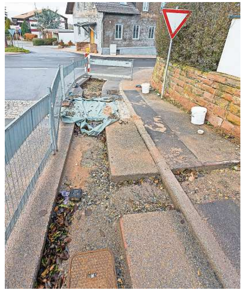
So wie hier im Grunbacher Weg sieht es seit Monaten an vielen Stellen in Engelsbrand aus. Bis Frühjahr kann der Glasfaser-Bau nicht fortgeführt werden. FOTO: MORITZ
