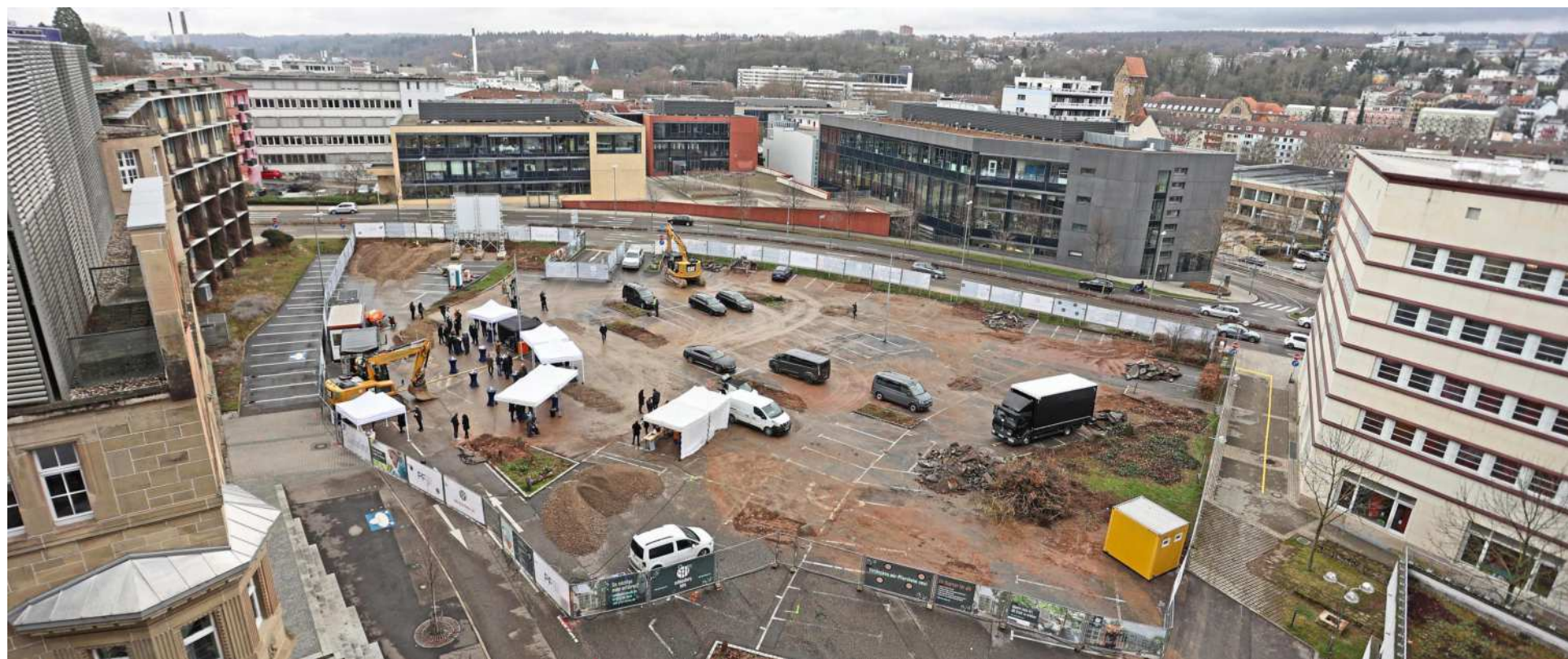
Blick von oben auf das 100-Millionen-Euro-Vorhaben Schlossberghöfe: Projektentwickler Wim ten Brinke will an dieser Stelle die City-Ost hochziehen. Ab sofort haben die Bauarbeiter das Sagen auf dem Areal. Fotos: Jürgen Müller
