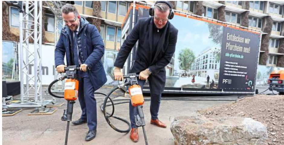
Sie greifen zu schwerem Gerät: Oberbürgermeister Peter Boch (links) und Investor Wim ten Brinke setzen beim feierlichen Spatenstich auf den Presslufthammer.
